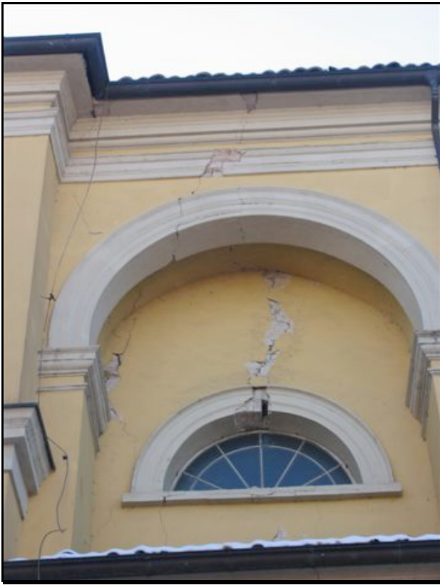
Foto n. 17 - San Vitale di Baganza (Sala B.): lesioni passanti
