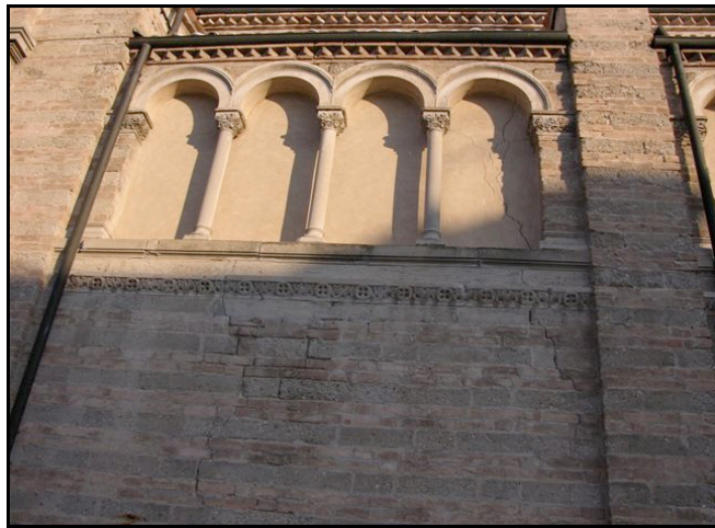
Foto n. 9 - Montechiarugolo: lesioni alla rocca
