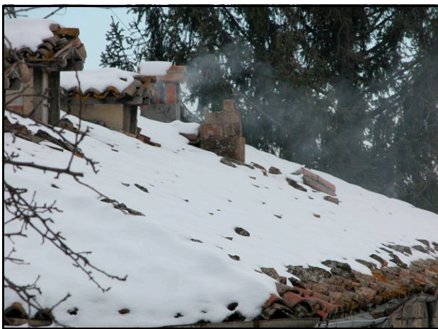
Foto n. 10 - Neviano degli Arduini: rottura di camino
