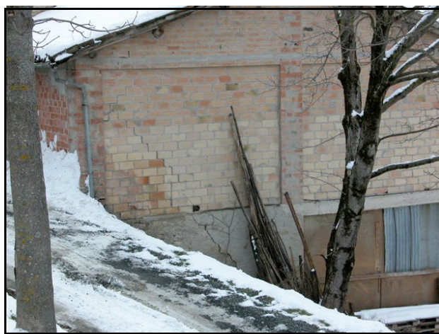
Foto n. 26 – Vezzano (Neviano degli Arduini): lesione esterna
